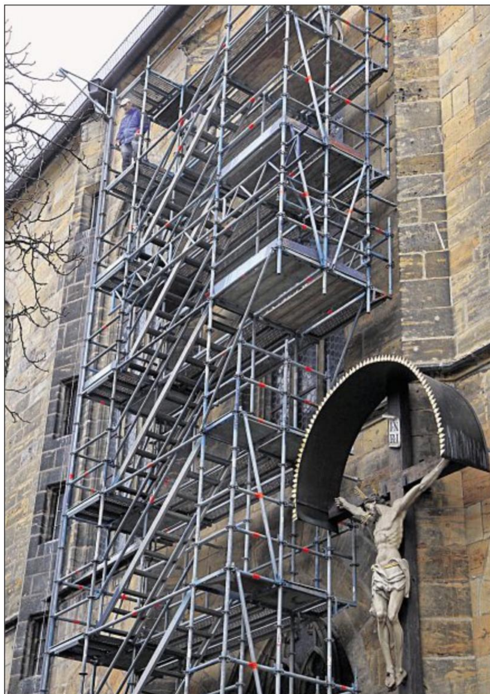
Dieses Gerüst dient dazu, vor der Turmsanierung den Glockenstuhl und die Decken im Inneren der Basilika zu stabilisieren. Bilde: Steinbacher (2), hzf
