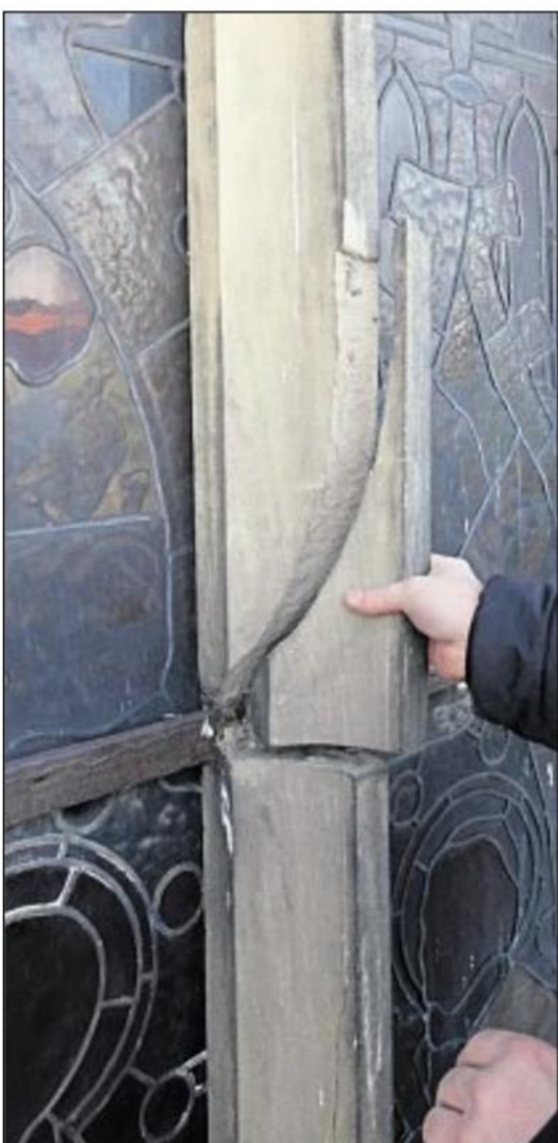
Teile wie diese drohten ungeschützt auf den Marktplatz zu fallen.
